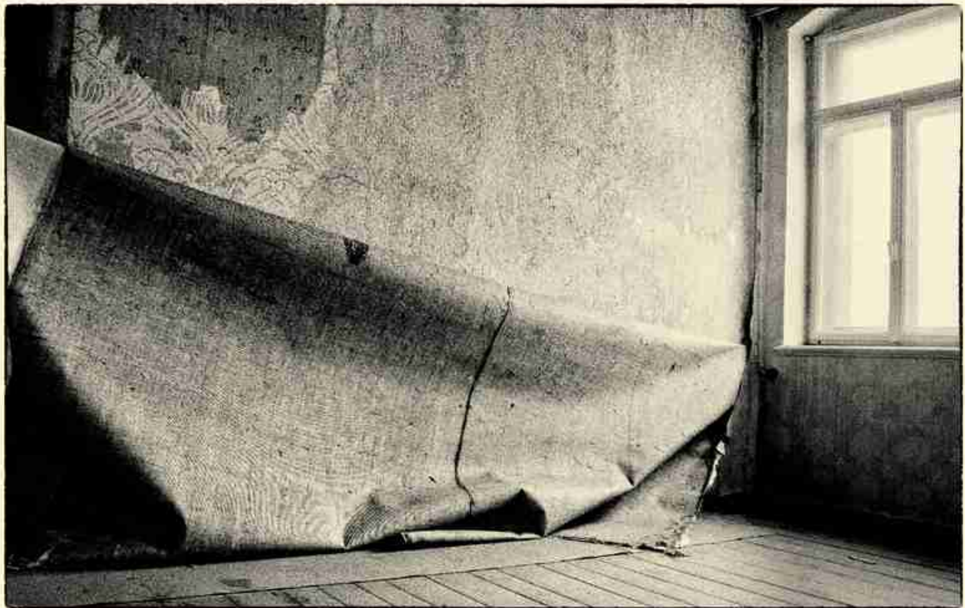
Abfallende Tapeten – Altbauwohnung Bergstraße
